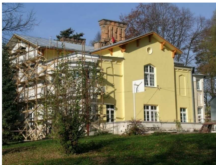
Fot 44 - Strzyżów. Pałac Wołowickich – Konopków, obecnie Dom Dziecka im. J. Korczaka w trakcie modernizacji w ramach projektu ZPORR. Inwestycja Powiatu Strzyżowskiego
