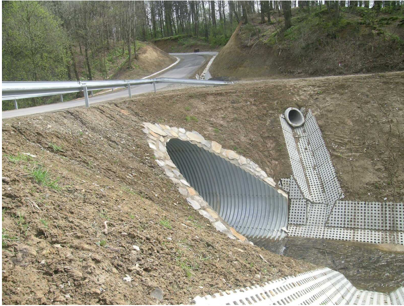
Fot. 10 - Wysoka Strzyżowska. Rozwiązania odwadniające i zabezpieczające korpus drogi powiatowej Wysoka Strzyżowska – Gbiska – Strzyżów
