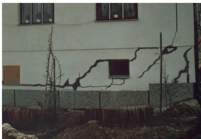
Uszkodzenia budynku mieszkalnego wskutek osuwisk – Gwoźnica Górna
