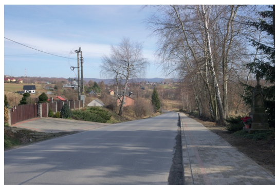
Budowa chodnika w miejscowości Glinik Średni w ciągu drogi powiatowej nr 1323R Frysztak–Gogołów–Klecie. Wartość: 1 122 146,74 zł
