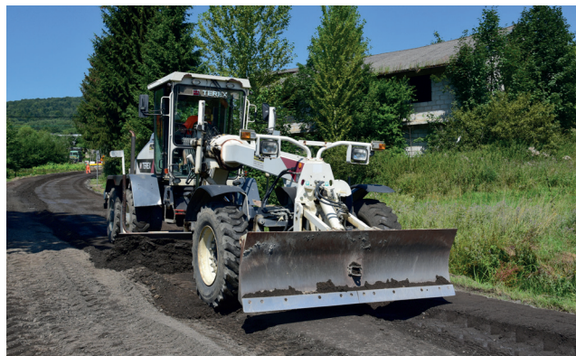
Przebudowa drogi powiatowej nr 1320R Cieszyna–Huta Gogołowska–Kamienica wraz z przebudową mostów i przepustu w miejscowościach Sępina i Huta Gogołowska. Wartość: 1 634 806,53 zł. Okres realizacji: 2017 r.
