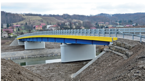
Przebudowa mostu w ciągu drogi powiatowej nr 1930R Żarnowa-Glinik Zaborowski w miejscowości Zaborów. Wartość: 5 735 560,36 zł
